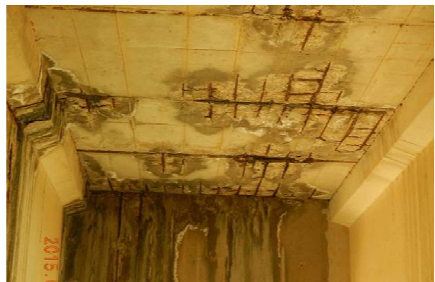
Ammaloramenti intradosso soletta
