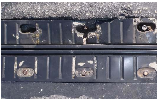
Danno di un giunto elastomerico
